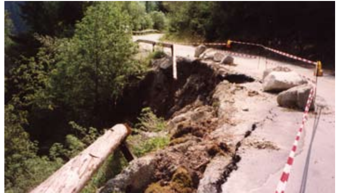
Schäden durch Hangrutschung an der Köfler Straße.
