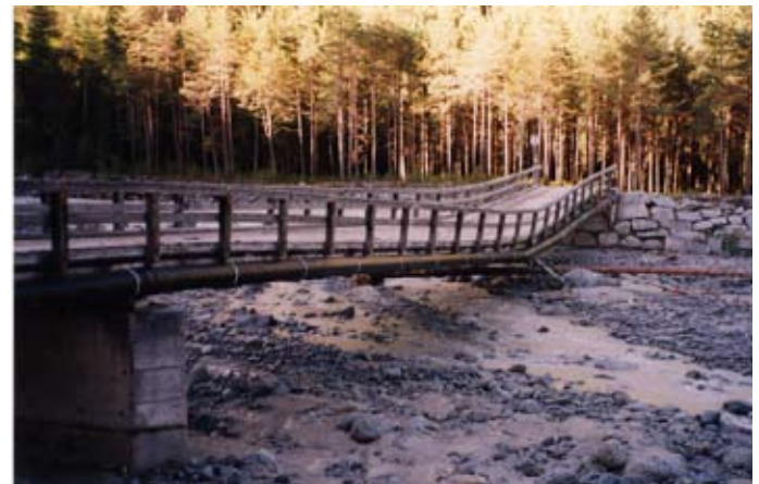
Hochwasser am 20. September 1999 zerstörte die Fundusbrücke.
